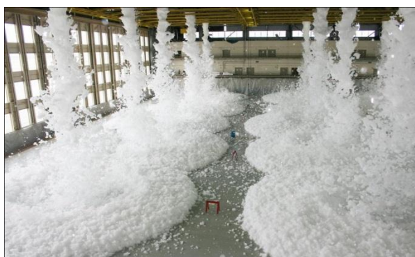
Рисунок 4 - Спринклерная установка пожаротушения
